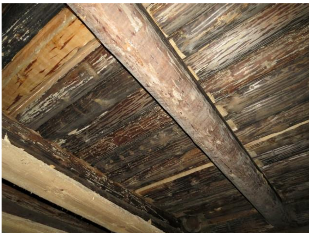
2. Балки перекрытия и балки накатов, пораженные пленочным грибом
