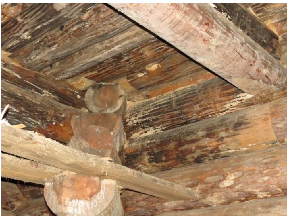
4. Пораженные участки угловых соединений бревен
